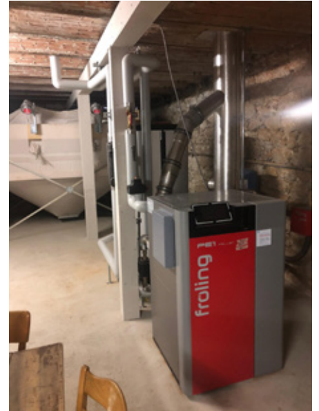
Der neue Pelletskessel im Keller des Wohnhauses. Im Hintergrund ist das Pelletssilo zu erkennen – ein «Sacksilo» mit textiler Umfassung. Bild: klik
